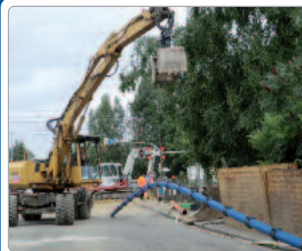
Wasserrohrbruch Inkofener Straße
