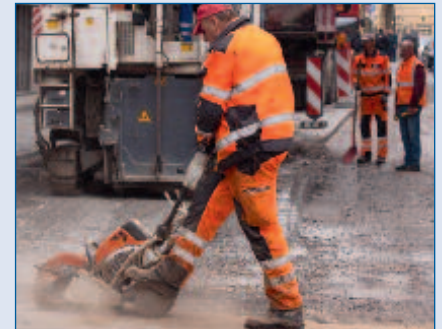
Fatal: Straßenarbeiter, die einer hohen Lärmbelastung ausgesetzt sind, ohne Gehörschutz.
