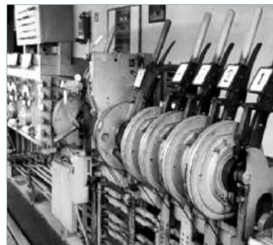
Die alte »Bedientechnik« aus dem Jahr 1893 für Weichen und Signale im Stellwerk des Fahrdienstleiters im Bahnhofsgebäude
